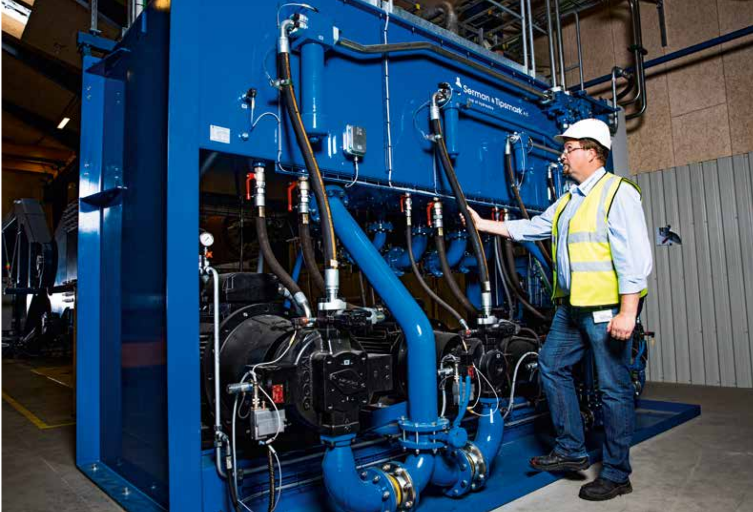
Maskinmester Morten Nørgaard Nielsen ved pumpestationen fra Serman & Tipsmark – en såkaldt Hydraulic Power Unit – som leverer hydraulisk tryk til testbænken. Kapaciteten er på 350 kW – med en olietank på 5.000 liter.
